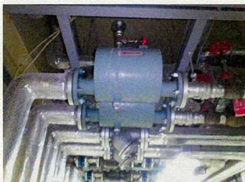
③ 気水分離器、ストレーナー露出状況
