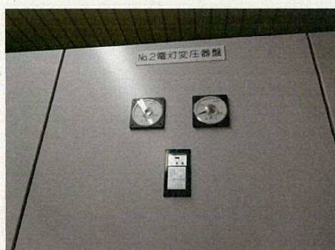
No. 2電灯変圧器盤
