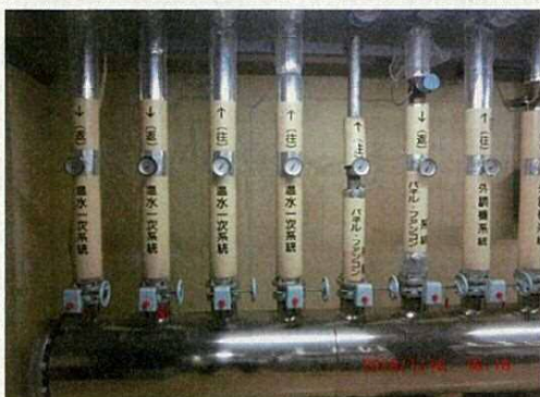
① 配管部分の保温は良好
