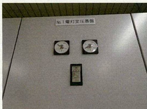
No. 1電灯変圧器盤
