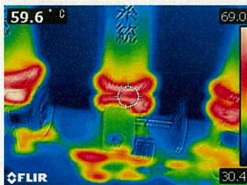
② ヘッダー接続バルブ部分は保温がなく高温
