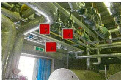
写真1 未保温弁周り配管箇所
